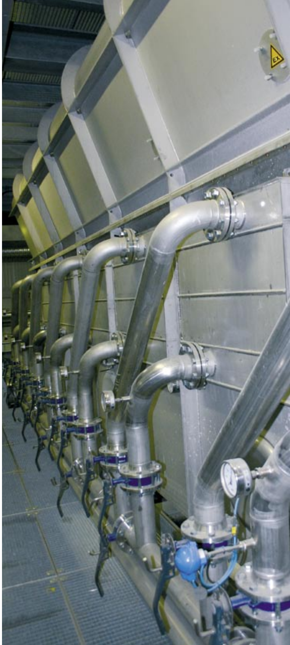
Wirbelschichtkühler Zuckerfabrik Ste.Emilie, Frankreich
